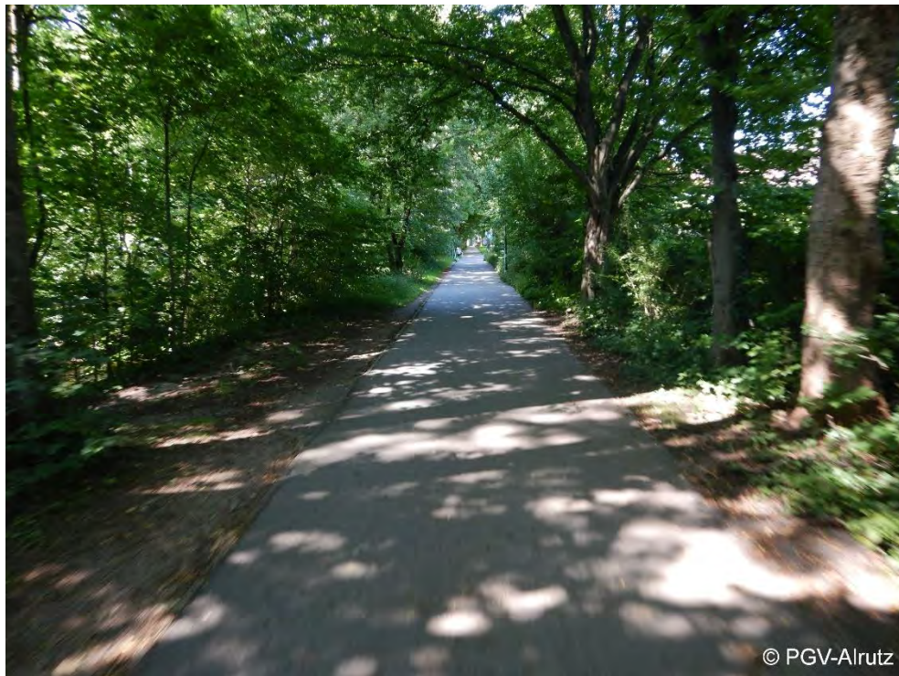
Abb. 5-13 Gemeinsamer Geh- und Radweg Canalettostraße bis zur Dantestraße, Blickrichtung Westen: verdichtete Flächen beidseits der befestigten Fläche weisen auf eine unzureichende Breite des befestigten Weges hin
